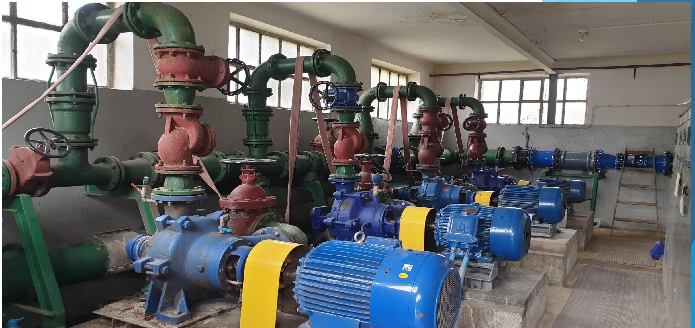
Układ pompowy z silnikami stałobrotowymi o mocy 45 kW każdy, przed modernizacją
