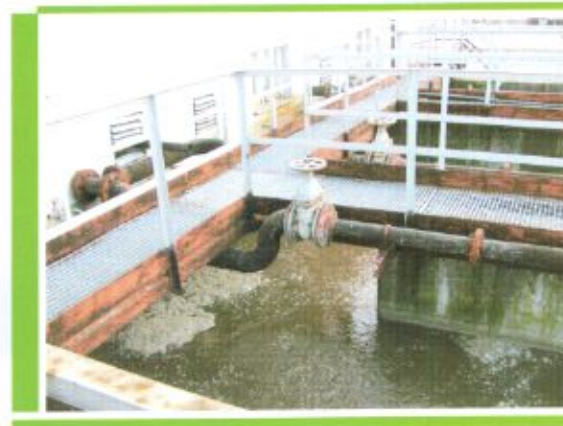
Foto: Oczyszczalnia ścieków w Krzeszowicach
